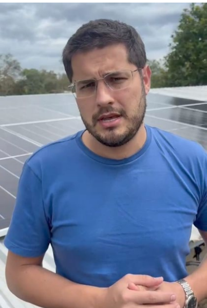
O vereador Xandão Tosini tendo, ao fundo, as placas de energia fotovoltaica instaladas no PEVI
