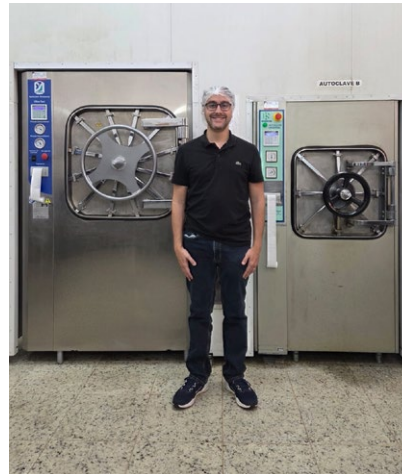
Rubinho junto à nova autoclave da Santa Casa, com capacidade para 520 litros
