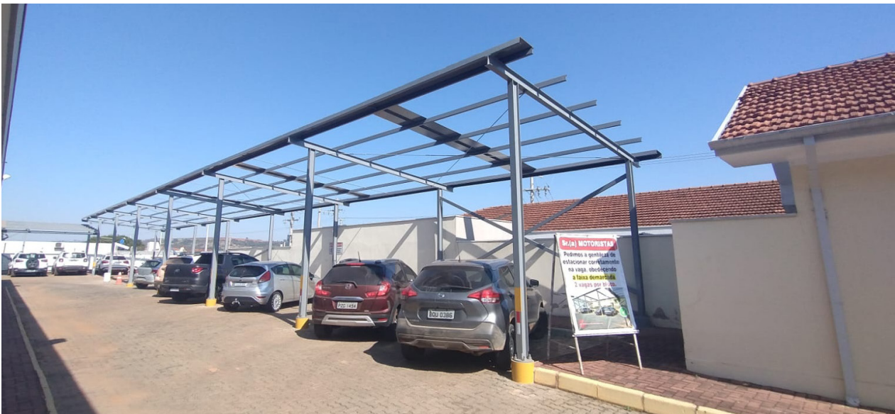
Uma das estruturas Carport Solar da Santa Casa, que alia a proteção de veículos à geração de energia elétrica limpa e renovável
